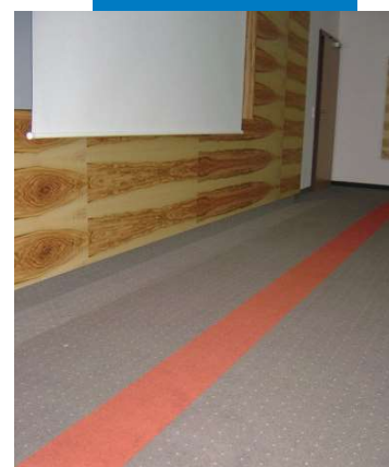
Hình ảnh Primer G được thi công trước khi trải Ultraplano Eco và chất kết dính Rollcoll để kết dính thảm trong phòng khách sạn - Villa Hotel Castellani - Áo
